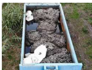
Exemple de lingettes agglutinées dans un bassin de station d'épuration
